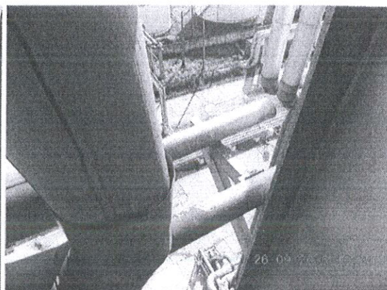
Foto4-lipsa suport de ghidare
